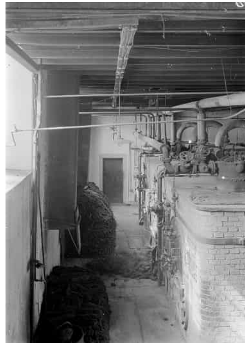
Die ehemalige Dampfheizung des Klosters Einsiedeln wurde teilweise mit Torf befeuert (Auf Bild links sichtbar)
